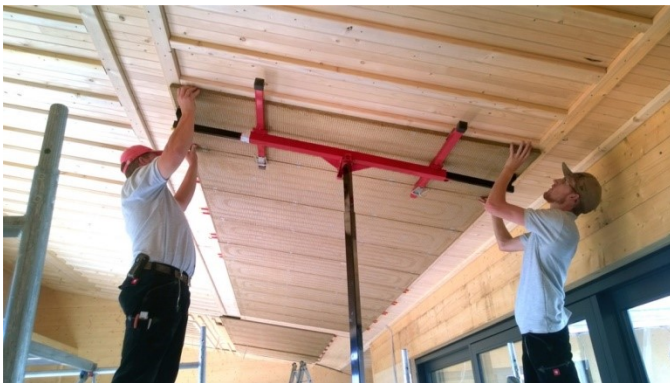
Abb1: WEM Klimadecke aus Lehm im Holzhaus
