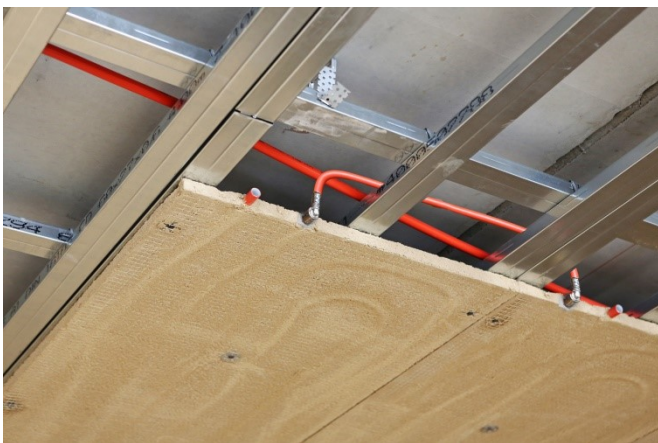
Abb 2: WEM Klimadecke aus Lehm im Industrie-/Bürogebäude
